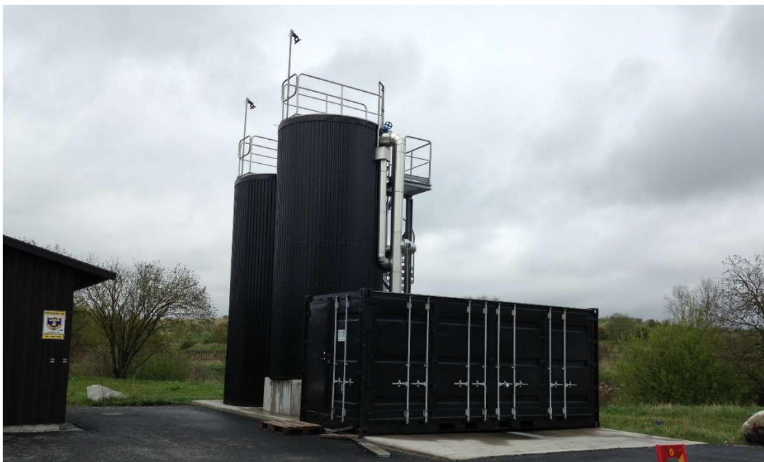
Figur 1: Del av vattenreningsystemet för processvatten från hagby återvinningsanläggningen. Containern i förgrunden rymmer en fällningsanläggning och cisterna i bakgrunden är filter.
